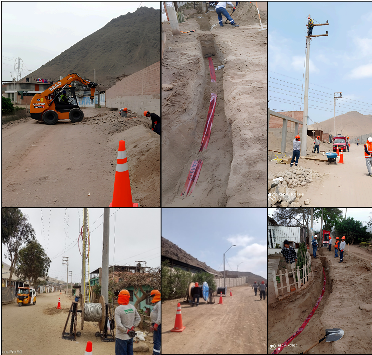
ELECTRIFICACION ZONA URBANA MT, BT, AP.
